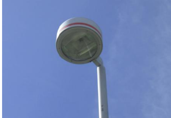
Figura 4-17 Luminarias a prueba de explosiones
