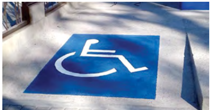
Construcción de caseta para equipo de bombeo, pintura de tapial, señalización de accesos en Terminal del Sur
