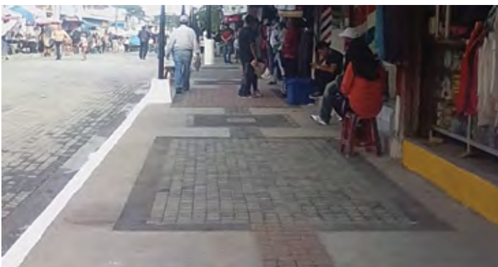
Construcción de 286.00 m 2 de acera sur mixta (concreto y adoquín) y 132.0 ml de cordón cuneta en calle Ciriaco López.
