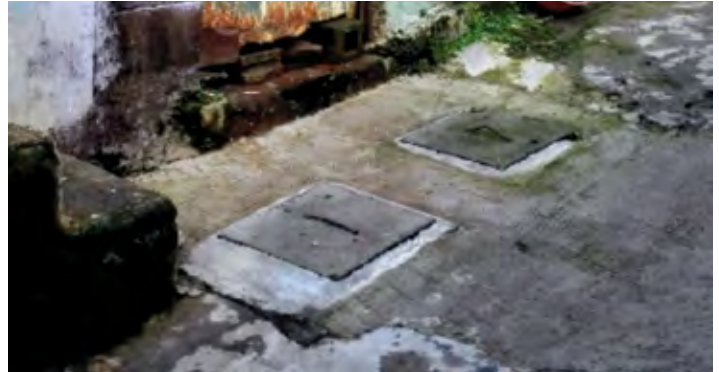
Introducción de agua potable y alcantarillado sanitario en comunidad San Martín del Bálamo
