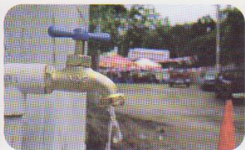
Una de las apuestas es dotar a la población de la zona rural del servicio de agua potable
