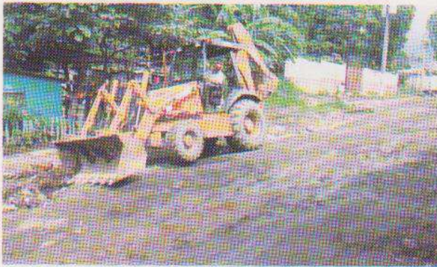
La apertura y mantenimiento de caminos permite la conectividad del municipio y agiliza el comercio
