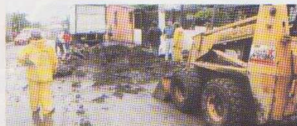
El Plan de Emergencia Municipal impidió que los daños fueran mayores
