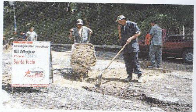
Trabajos de bacheo en Calle San Miguel de la Col. San José.
