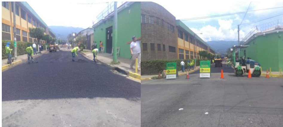
09/09/2019: Bacheo sobre la 3ª Avenida Nte.
